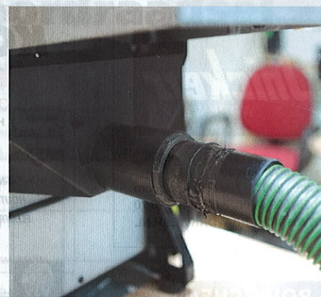
Verloopstuk met smalle slang = verstopping. Oplossing: brede slang plaatsen met daarachter een stofzuiger met een flinke capaciteit.
